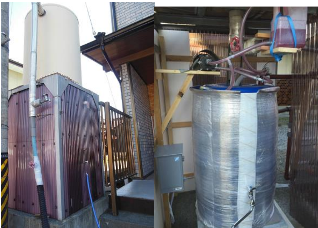
（玄関前温泉タンク。下に貯湯タンク）
