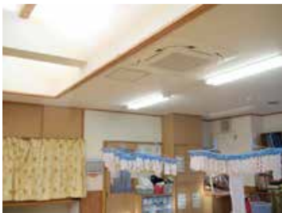
今年度新たに設置した中洲保育園のエアコン
