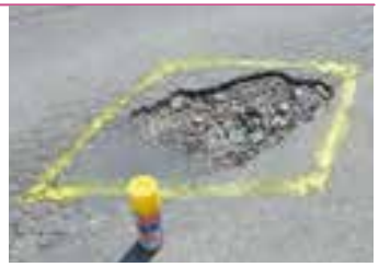
損傷を確認 修理待ちのマーク
