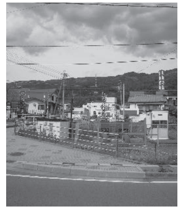
清水町の内水排除ポンプ
