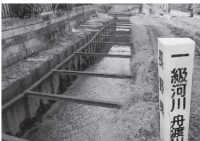
懸案の1級河川舟渡川 水面下で腐蝕が進む護岸の矢板
