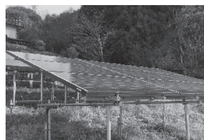
空き地利用の太陽光発電システム
