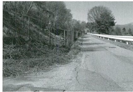
点検・整備が急がれる中央道側道
