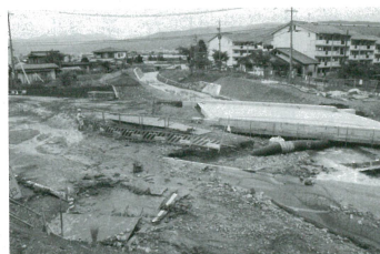
権現沢川崩落現場
