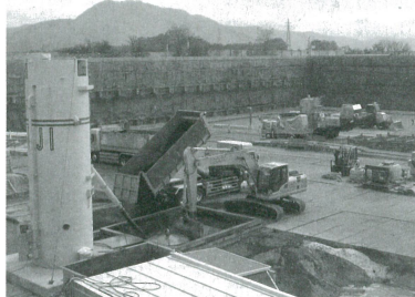
焼却灰処理施設
