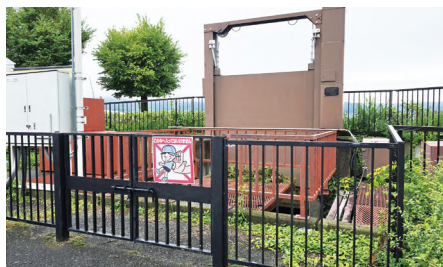
千貫溝の排水ポンプ
