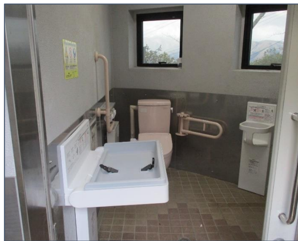
ベビーシートの設置（多目的トイレ）
