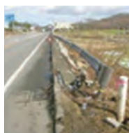
ガードレール・標識などの損傷
