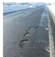
路面の穴ぼこ・段差
