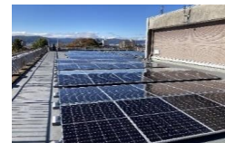
市庁舎屋上の太陽光発電設備
