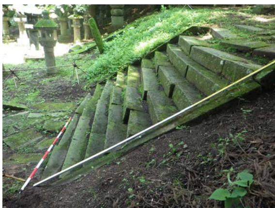
階段の変形（参道エリア）
