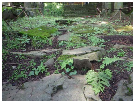
入口付近（中段）の不陸と雑草の繁茂
