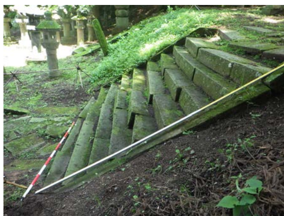
図 2-12 階段のはらみ出し
