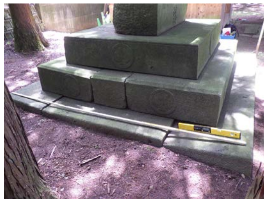
図 2-2 基壇中央部の沈下 (5代忠林墓標)
