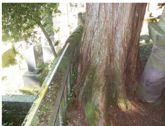
図 2-24 樹木の影響による玉垣の変形
