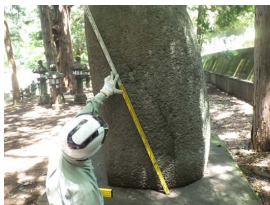
図 2-3 墓標側面の亀裂 (8代忠恕墓標)
