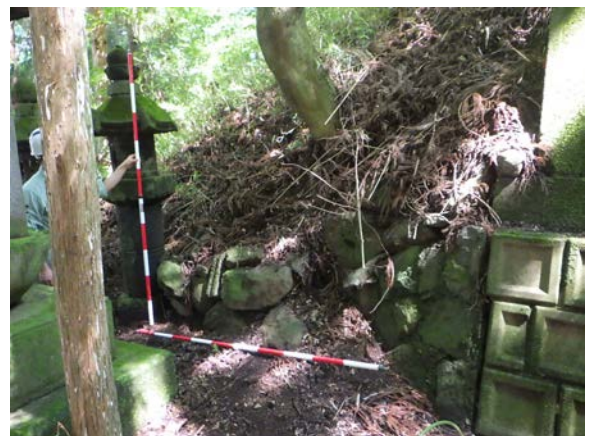
図 2-15 樹木の影響による石垣の崩壊
