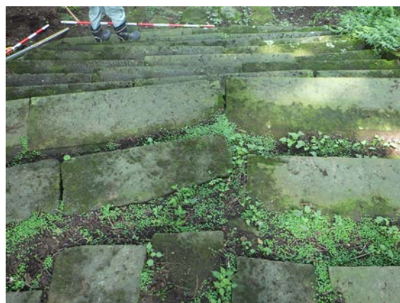
階段のはらみ出し（参道エリア）
