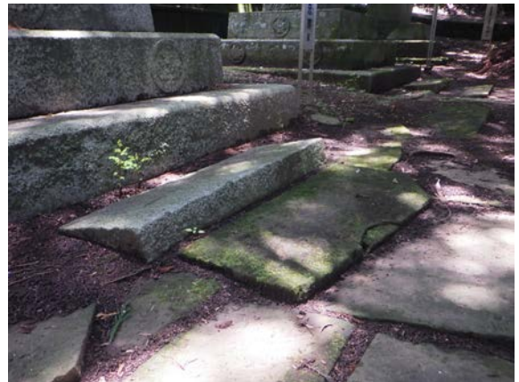
3代忠晴墓標前の拝石の沈下
