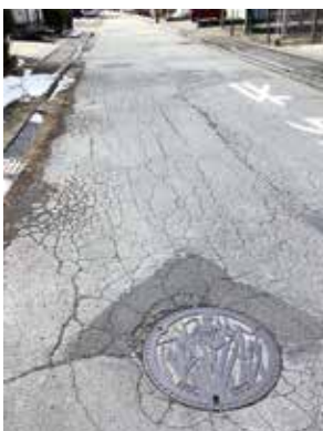
日陰の残雪と割れた舗装
