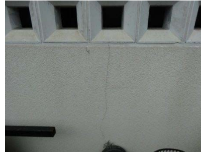
エ) 表面仕上げのクラック
