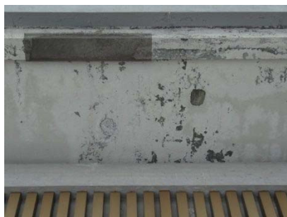
ア) 水が廻ったことによる表面の劣化
