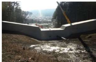
整備された砂防えん堤 下に見えるのは上の原小学校
