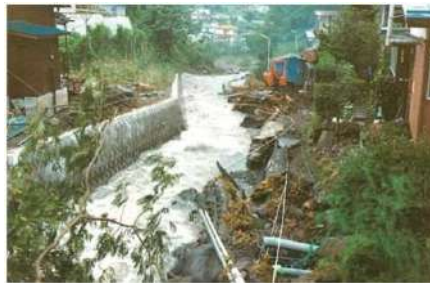
角間川中流部被災状況
