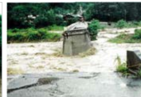
写真-5 台風10号により被災した富士見町武川橋
