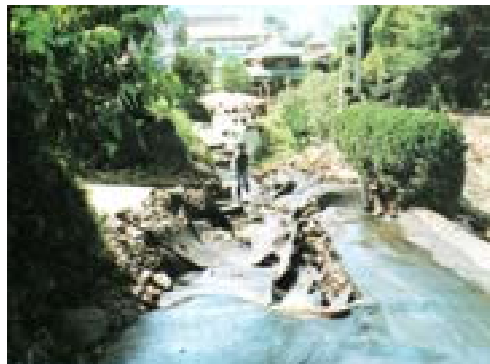
写真-2 道路の舗装はほとんどめくれ上がった
