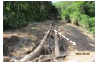
⑤被災状況 土砂流出量 4,000m 3
