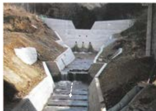
写真-5 中央道上に整備された砂防えん堤 高さ10m、堤頂長54m 昭和59年12月竣工
