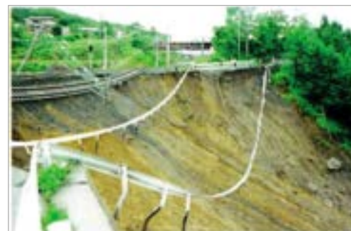
写真-4 台風10号の豪雨により被災した中央本線
