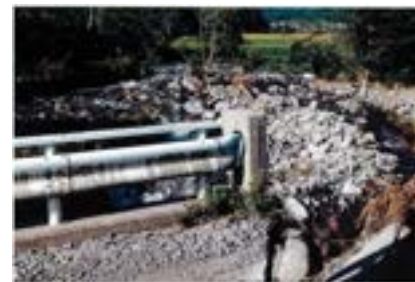
写真-6 被災状況
