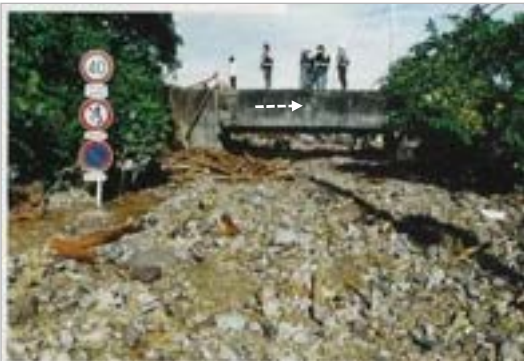
写真-1 水路橋から流出した土石流は県道岡谷茅野線を埋め尽くした。
