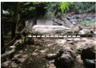
②コンクリートえん堤 高さ6.4m 長さ26.2m 昭和58竣工 えん堤天端上40cmに越流痕跡あり
