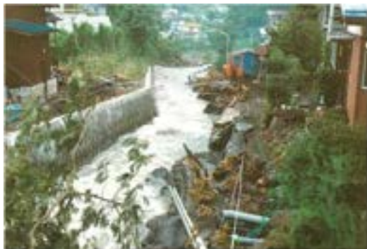
写真-1 諏訪市唐沢合流上流付近被災状況
