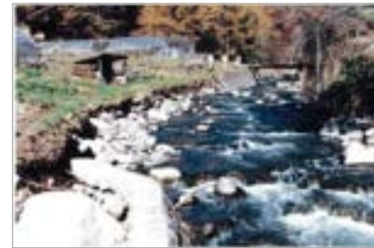
写真-1 被災状況
