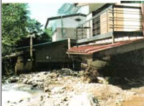
写真-1 1階は土砂で埋まった
