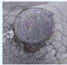
▲傷んだマンホール
