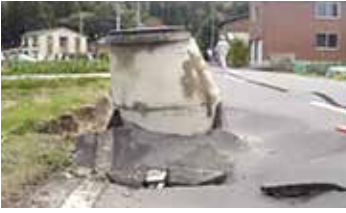
液状化で浮上したマンホール (写真提供：長岡市)
