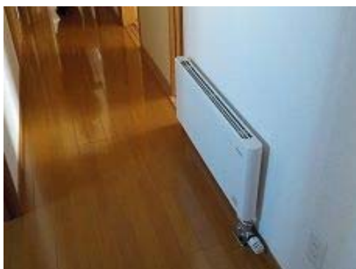
☞ 廊下 (パネルコンベクター)
