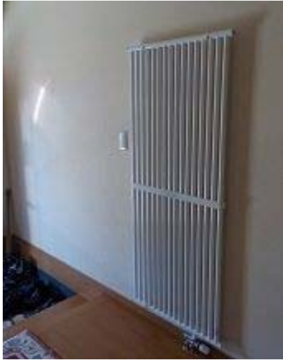
☞ 玄関横 (パネルラジエーター)
