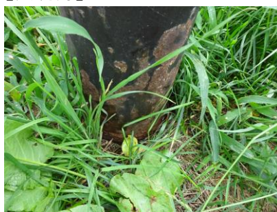
健全度C 塗装の劣化 (沖田公園)
