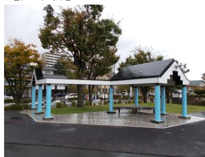
健全度B 屋根塗装劣化 (諏訪市湖畔公園)
