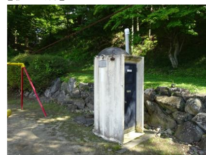
健全度C 外壁劣化 (西山公園)
