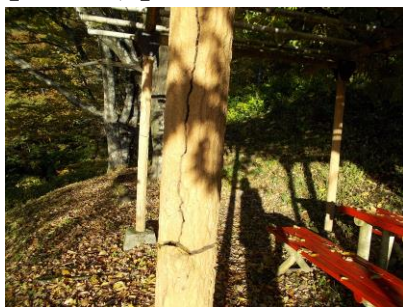
健全度C コンクリート擬木ひびわれ (立石公園)
