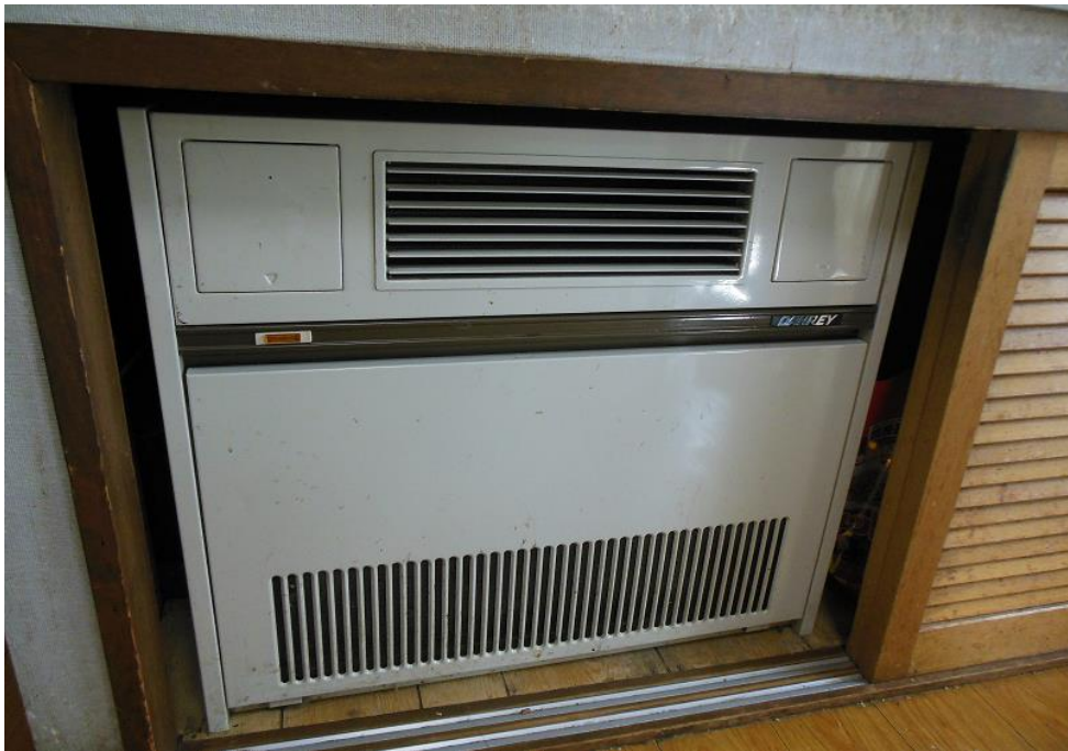
(リビングに設置された暖房器)
